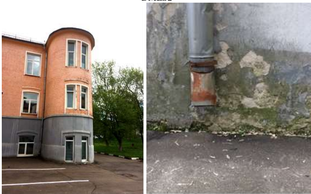
Ил. 7. Здание поликлиники №64 в Москве, памятник архитектуры, построено в 1931 году; биопленка зеленого цвета на стене около водосточной трубы
