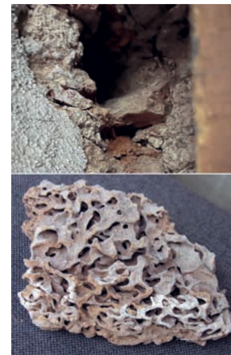
Ил. 42. Вверху: канал, образовавшийся в результате деформации дубовых связей в стене из плинфы (постройка XII века); частично заложен обломками кирпича. Внизу: гнездо муравьев-древоточцев, извлеченное из канала при освобождении его от остатков разрушенной древесины. Фото Н.Л. Ребриковой
