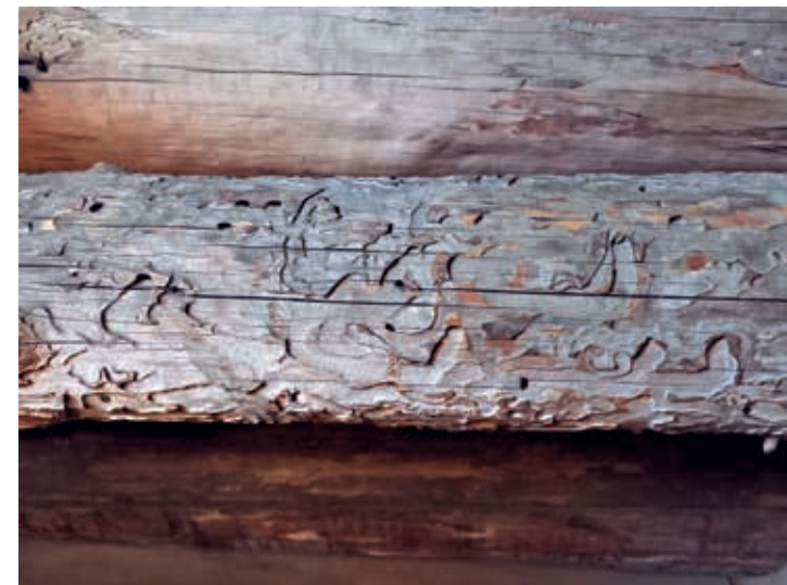
Ил. 37а. Повреждение бревна внутри деревянного дома фиолетовым усачом: личинки развивались под остатками коры в камбиальном слое; после отделения коры обнажились извилистые поверхностные ходы личинок. Фото автора
