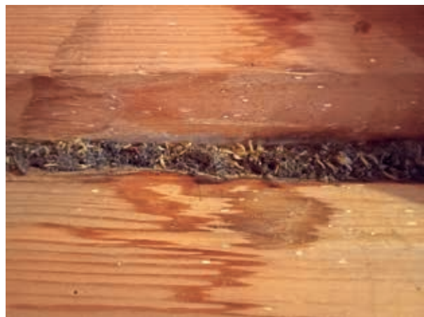
Ил. 74. Использование войлока для прокладки между бревнами сруба для улучшения теплоизоляции в постройке второй половины XX в. Видно разрушение войлока платяной молью; многочисленные оболочки куколок от вылетевших бабочек. Фото автора
