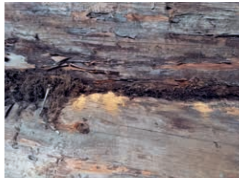
Ил. 16а. Повреждение бревен сруба (деревянный дом: подклет, внутренняя сторона) домовым точильщиком. Видны свежие осыпи буровой муки. Фото автора
