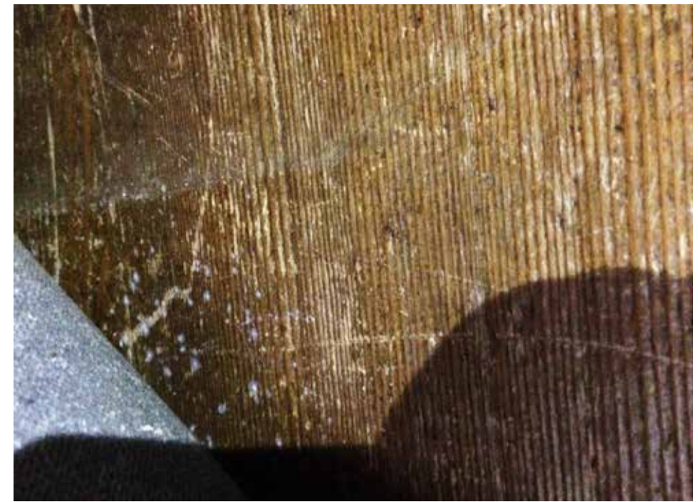
Ил. 32. Усадьба Останкино. Западный флигель дворца, «молоток». Микроколонию грибов на полу, которые были не заметны под покрытием
